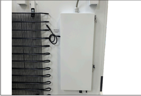
圆形电源线位于设备后部的接线盒内。
