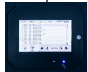
Registros de alarmas remotas
